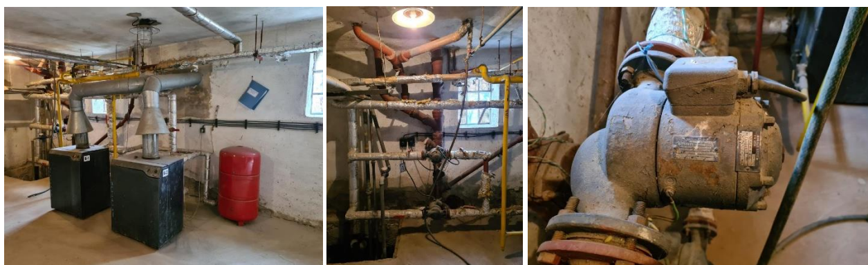
Obr. 13: Zdroj tepla – plynová kotolňa pre objekt
