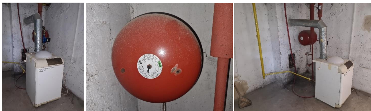
Obr. 12: Zdroj tepla – plynová kotolňa pre objekt, expanzná nádoba
