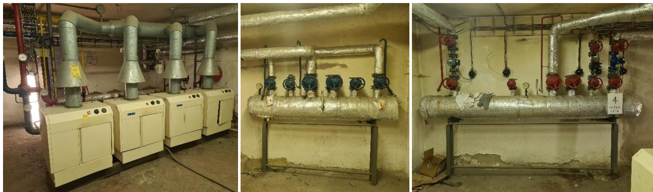
Obr. 12: Zdroj tepla – plynová kotolňa pre objekt
